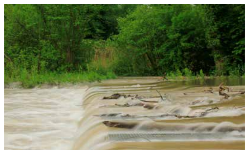
Ouvrage de connexion lors d'une inondation
